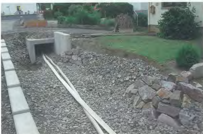
Bild 3: Winkel und U-Profile während der Bauphase mit eingebautem Sohlensubstrat (Foto: GASTRING INGENIEURE)
